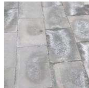
Cvjetanje vapnenca na površini neposredno nakon postavljanja opločnika
